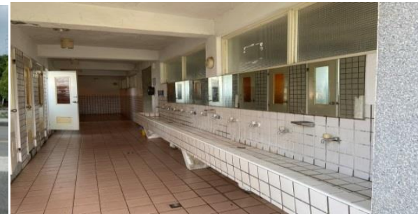
3 男/女廁間現況配置數量不符實需，設施老舊部份損壞。
